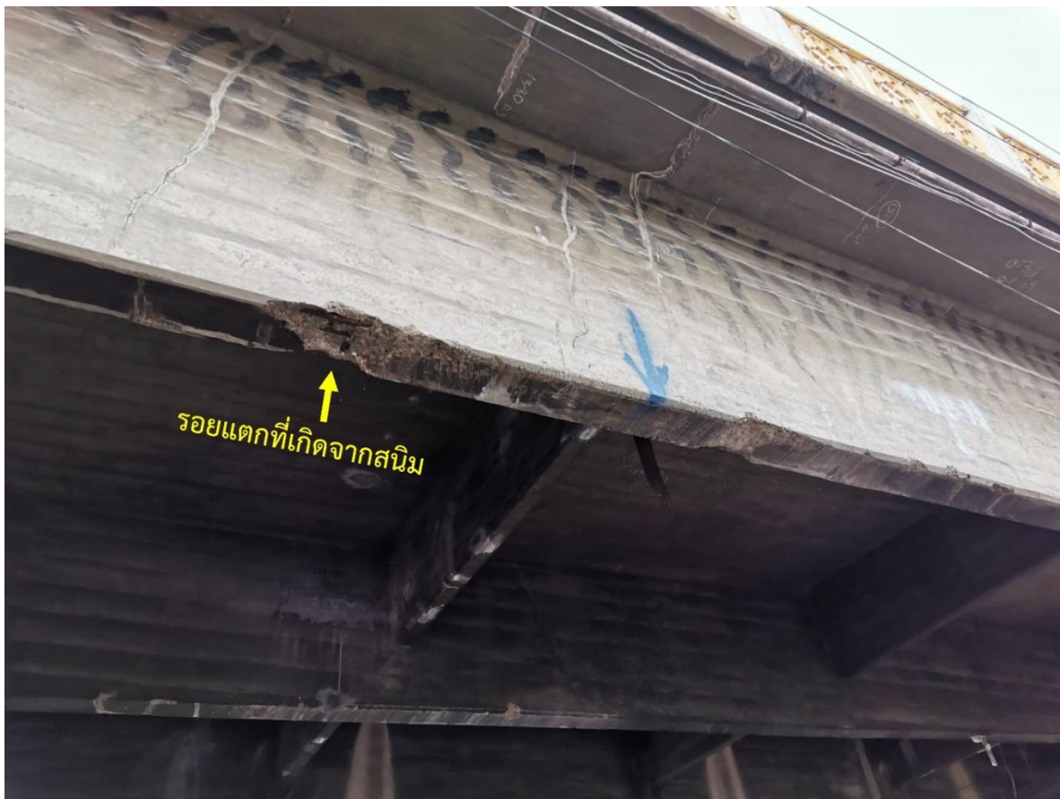
รูปที่ 10-15 สนิมที่เกิดขึ้นที่เหล็กเสริมและทำให้ผิวคอนกรีตหลุดกะเทาะ
